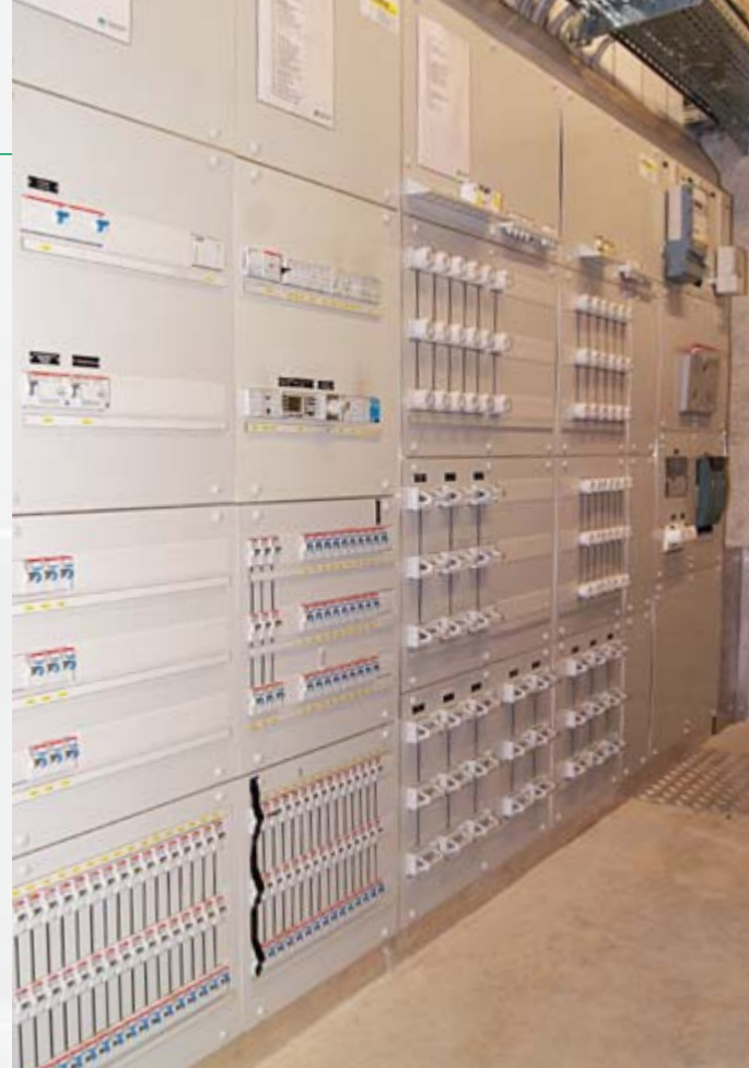
Im industriellen Bereich, nach dem Verteilkasten mit ein- und mehrphasigen Stromkreisen, ist eine Installationsbewilligung notwendig. Nur der Fachmann darf Installationen und Eingriffe an Festinstallationen vornehmen.
