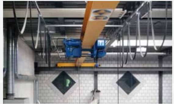
Die Hallenkonstruktion untersteht der Ausführungsklasse EXC 2, die Laufschienen und deren Befestigung vom Brückenkran jedoch der Ausführungsklasse EXC 3.
