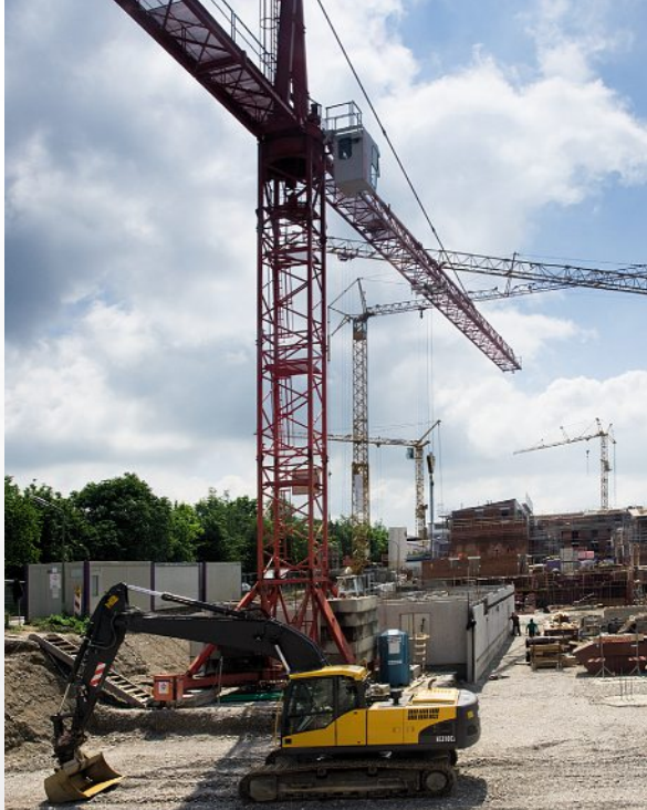
Krane der Kat. B.
